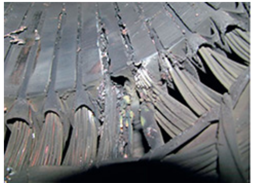
Figura 1. Núcleo con daño severo.
