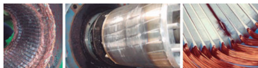
Figura 5. Daños típicos en núcleos laminados.
